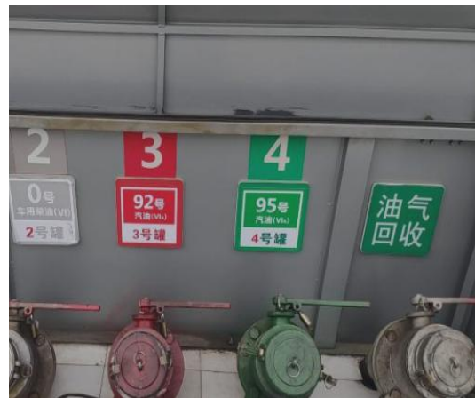
油罐卸车油气回收系统
